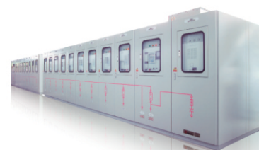
Switchgear Tủ đóng Cắt
